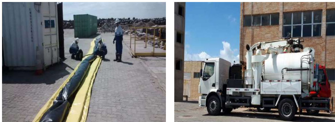
Figura 15 – Evidência de disponibilidade de recursos para armazenamento temporário (tanques flutuantes e caminhões sugadores locados no TMUT).
